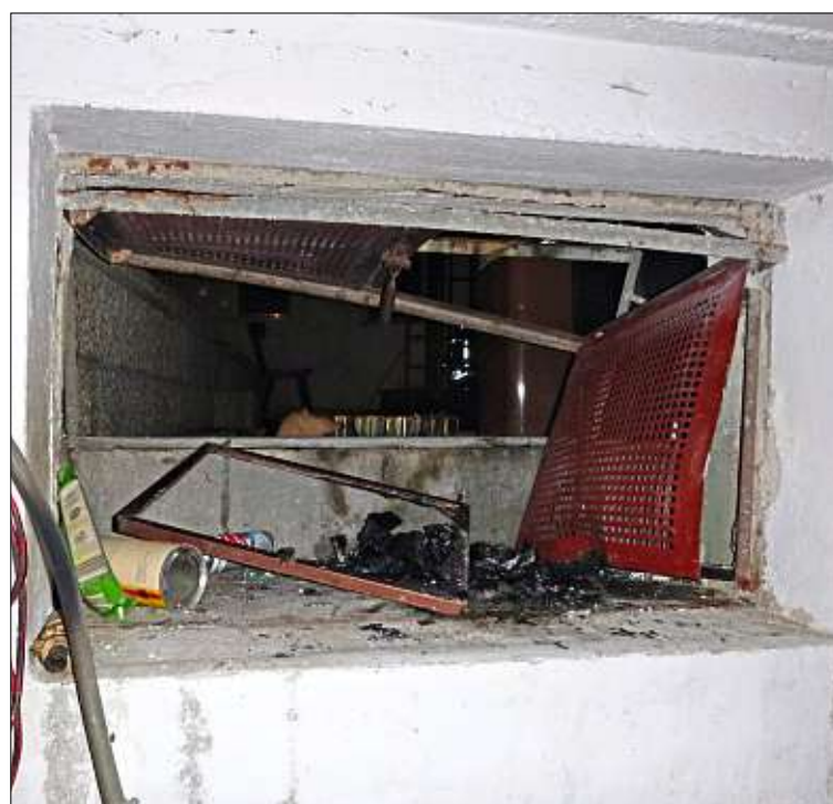
Auch dieses Kellerfenster wurde zerstört.
