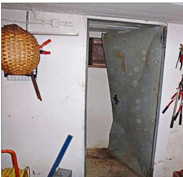
Eine dicke Stahltür wurde durch die Wucht der Explosion verbogen.
